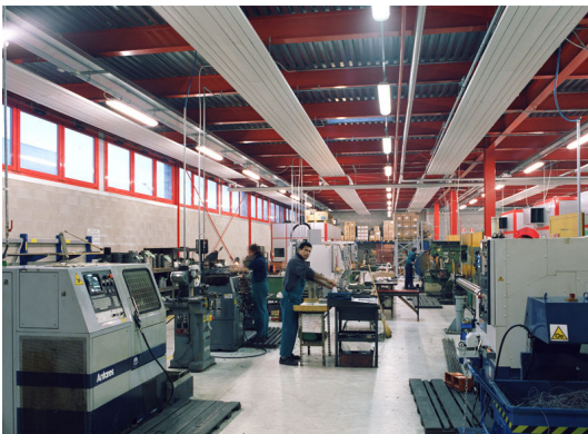
Figura 8 Il piano terreno con impianto a termostrisce radianti.
